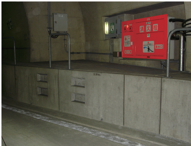
消火栓用および短切
