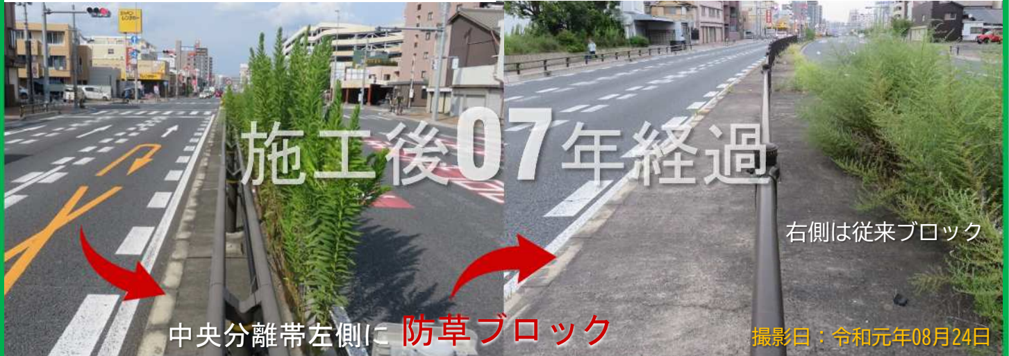
完成日：平成24年08月 製品名：歩車境界ブロック 名古屋国道事務所 平成22年度22号枇杷島電線共同溝名西工工事
